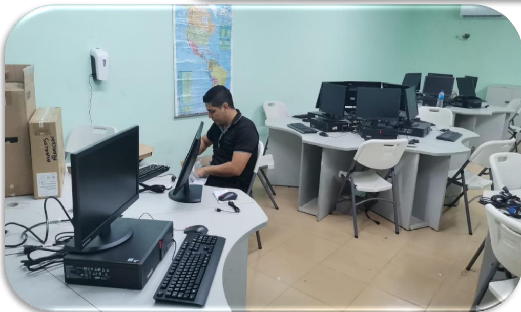
Instalación de punto de red, instalación y configuración de 31 equipos Lenovo M715s
